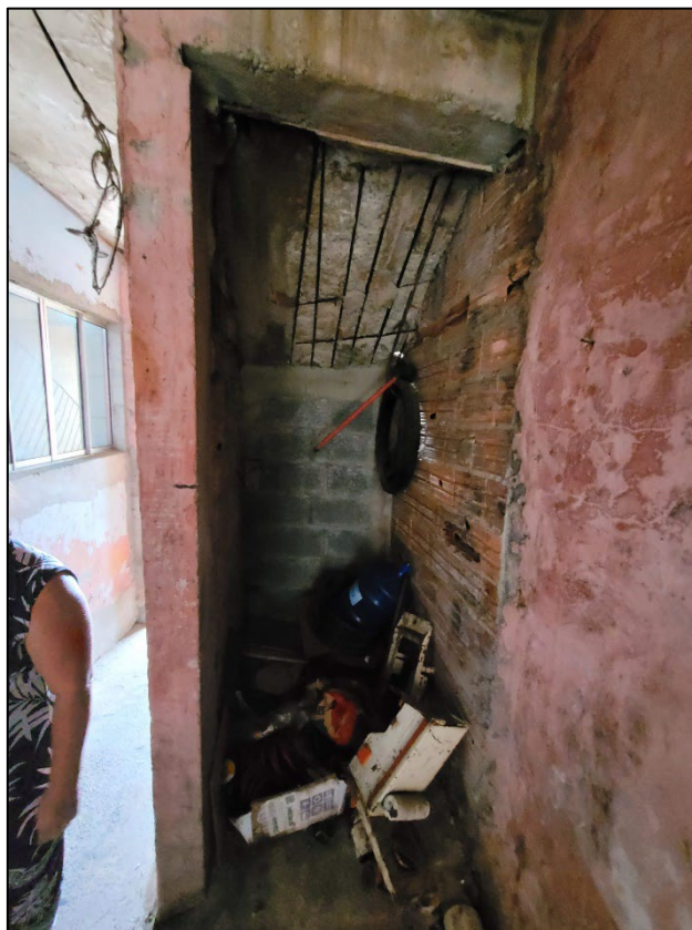
Figura 8 - Há ambientes sem uso e sem acabamento.
