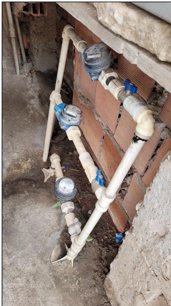
Figura 4 - Há três hidrômetros no prédio
