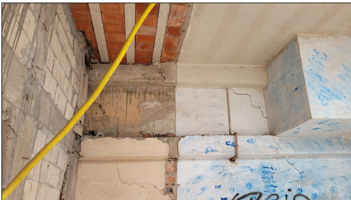
Figura 3 - Trincas na alvenaria
