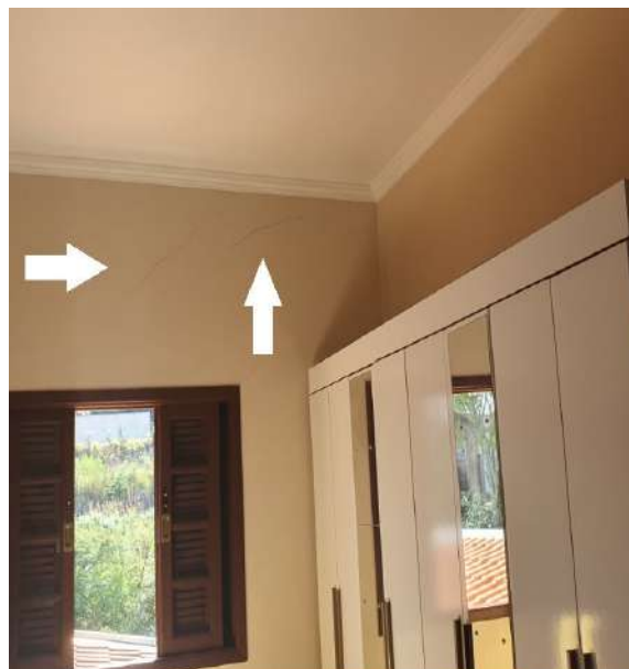
Rachadura no quarto com suíte
