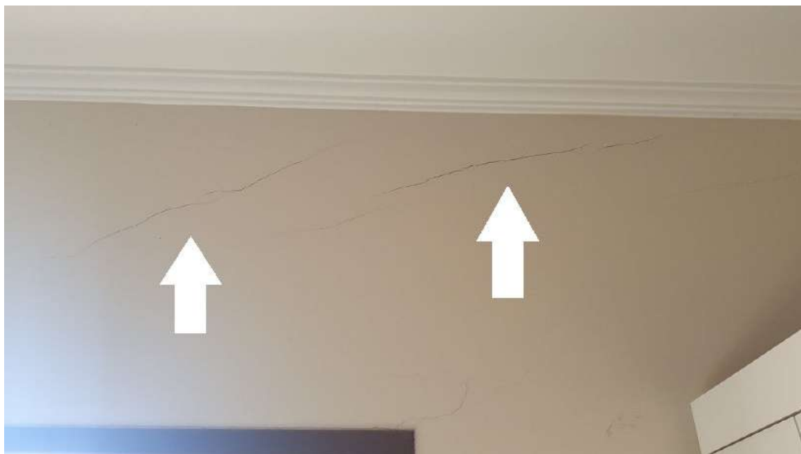
Detalhe das rachaduras aproximadas
